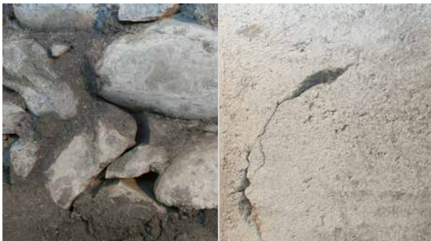
Goluri în zidărie
