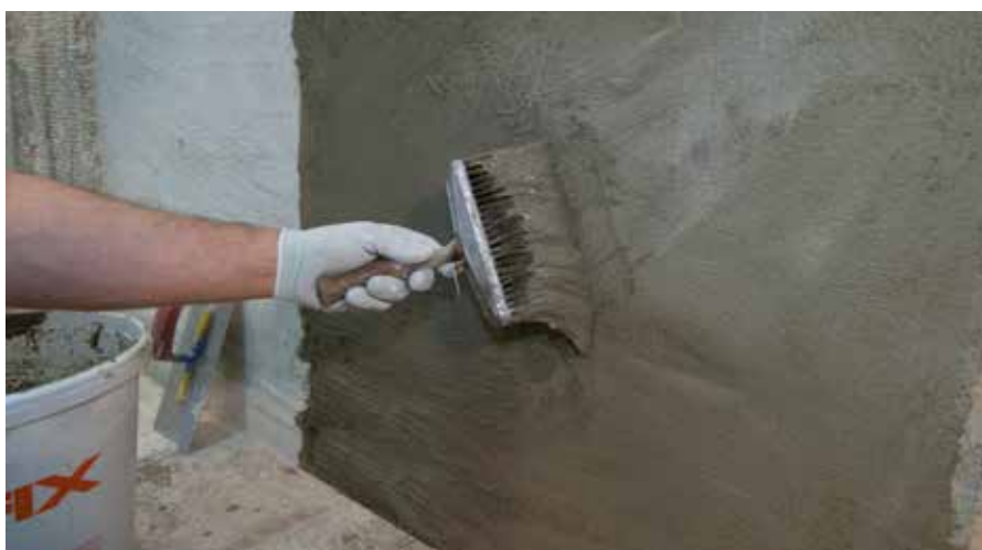
Aplicați mortarul de hidroizolație RÖFIX 636 Dichtungsschlämme cu o grosime max. a stratului 3 de mm peste RÖFIX 635
