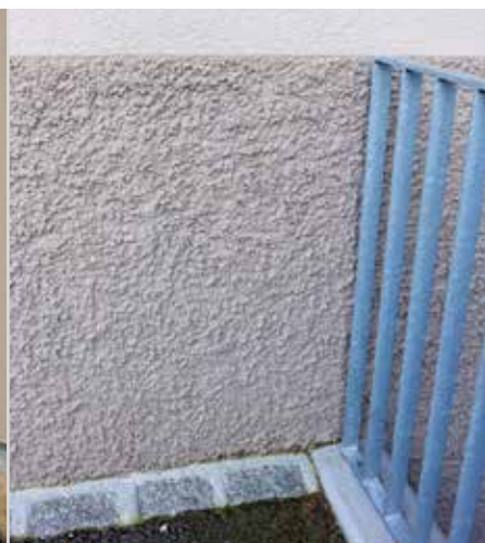
Trecere vizibilă soclu-fațadă
